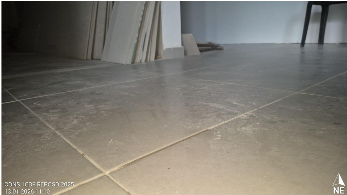
Imagen 1. Punto de filtración, gotera, en módulo de Coordinación en placa de piso en N0.00 – 4.00 m.
