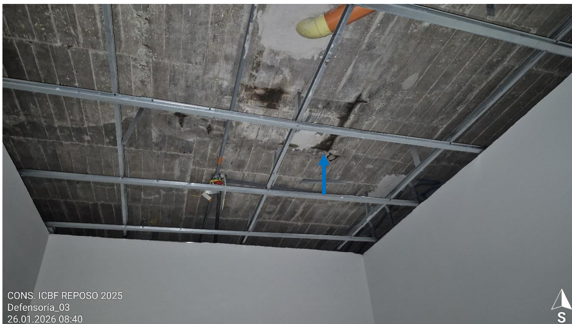
Imagen 3. Punto de filtración, gotera, en módulo de defensoría 02 en placa de techo en N0.00 – 4.00 m.
