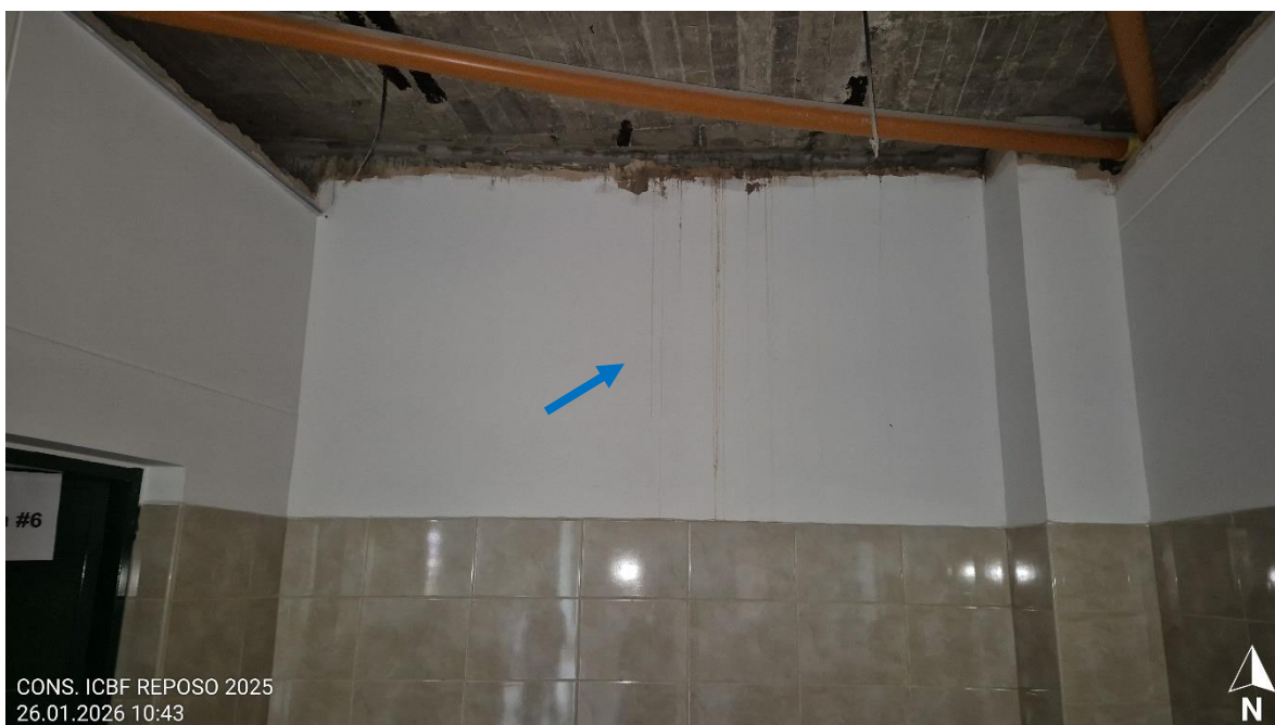
Imagen 4. Punto de filtración, en módulo de coordinación en placa de techo en N0.00 – 4.00 m.
