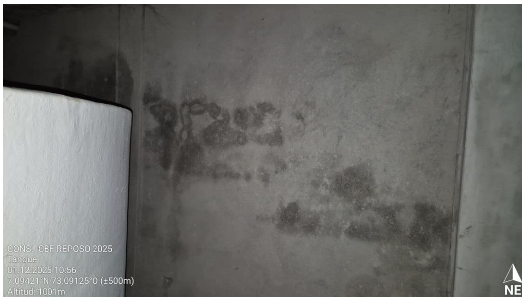
Imagen 3. Zona de humedad presentada en pared cuarto de tanques.
