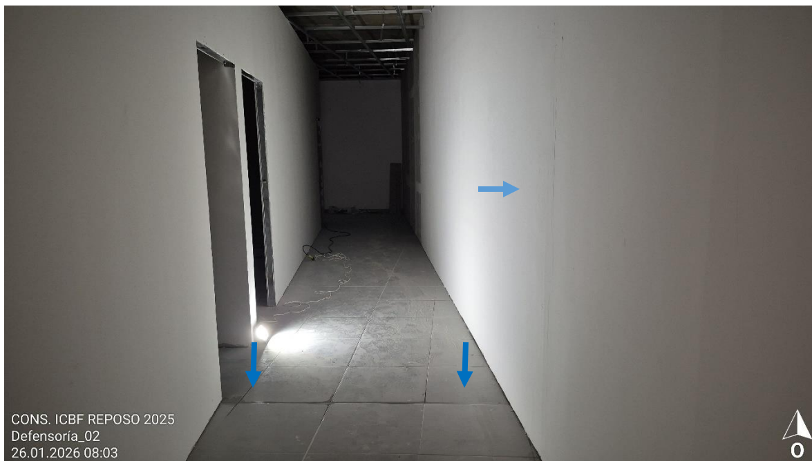
Imagen 1. Punto de filtración tras muro a una cara, frente a módulo de defensoría 02 en N0.00 – 4.00 m.
