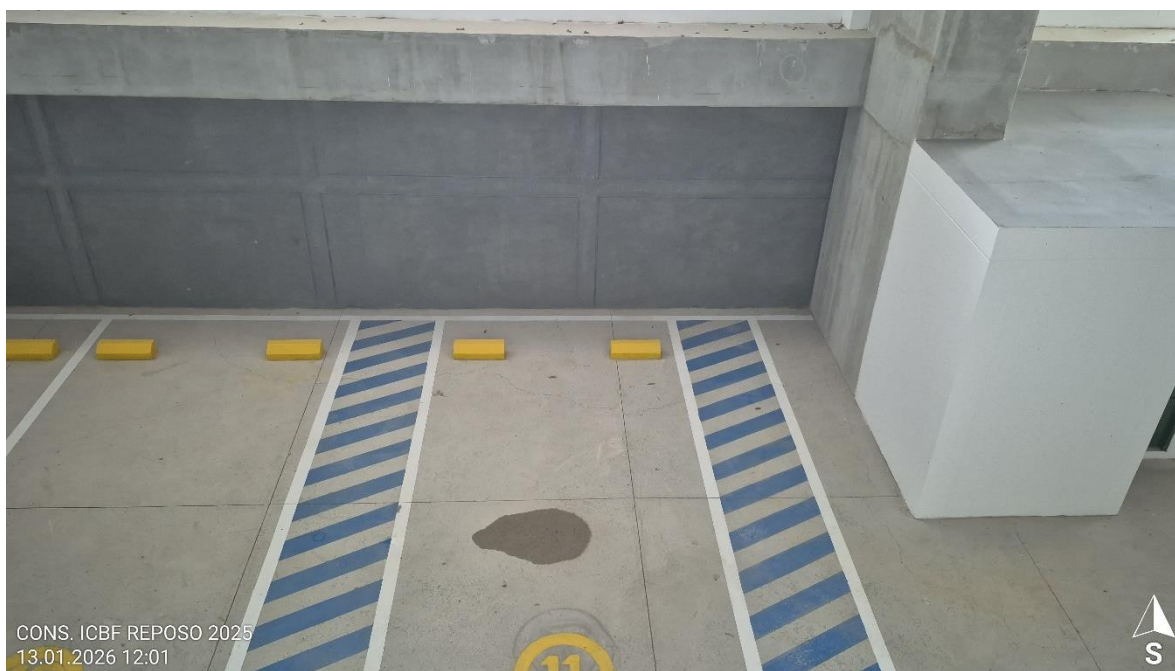
Imagen 4. Punto de filtración, gotera, Parqueadero 11 en placa de piso en N0.00 – 7.00 m.
