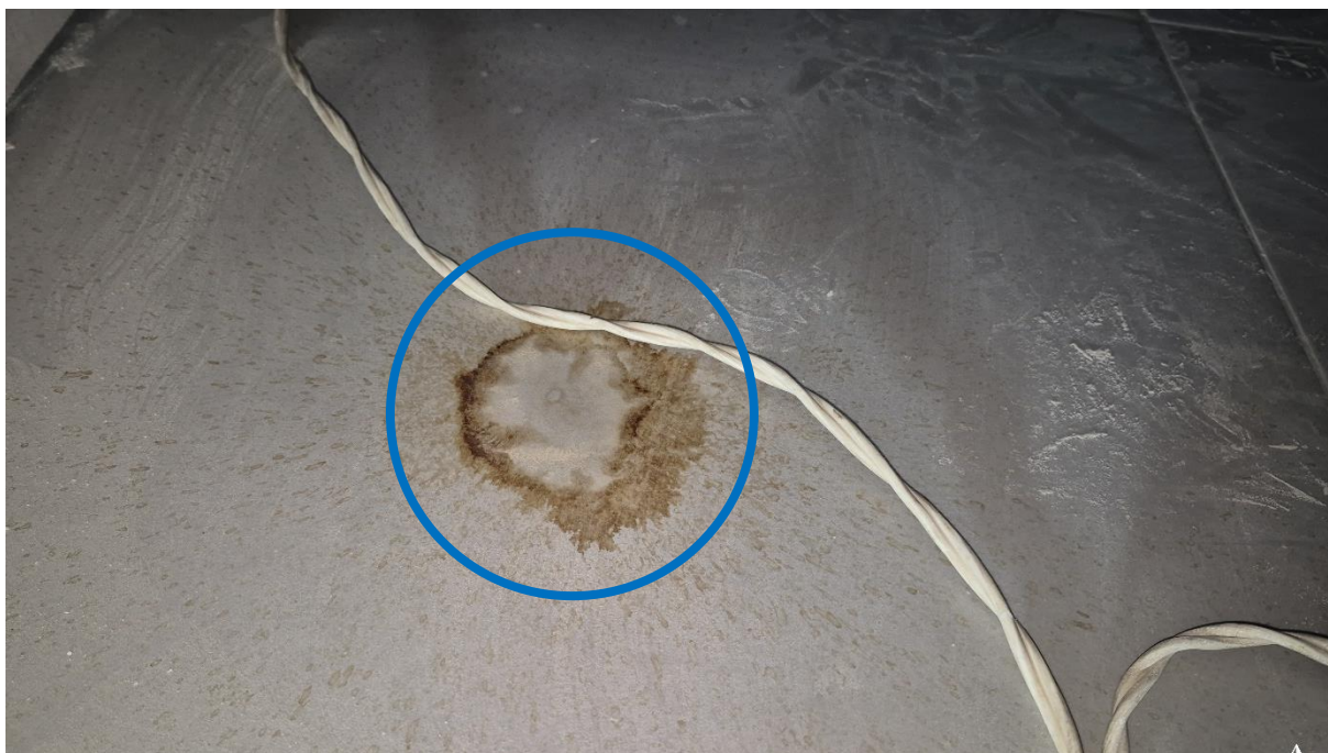
Imagen 2. Punto de filtración, gotera, en módulo de Nutricionista 01 en placa de piso en N0.00 – 4.00 m.
