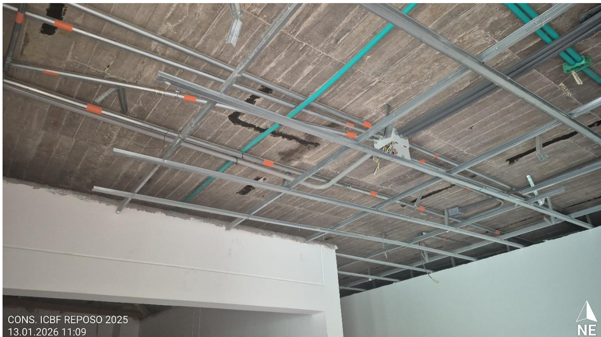
Imagen 2. Punto de filtración, gotera, en módulo de Coordinación en placa de techo en N0.00 – 4.00 m.
