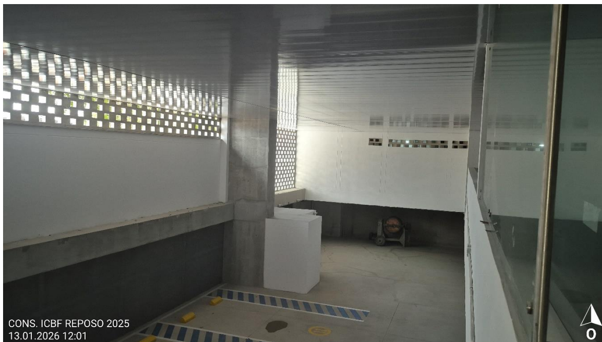
Imagen 3. Punto de filtración, gotera, Parqueadero 11 vista general en N0.00 – 7.00 m.
