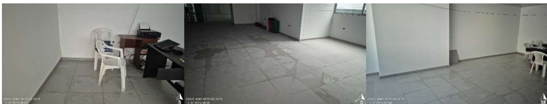
Imagen 2. Zona de primera infancia con presencia de infiltraciones.
