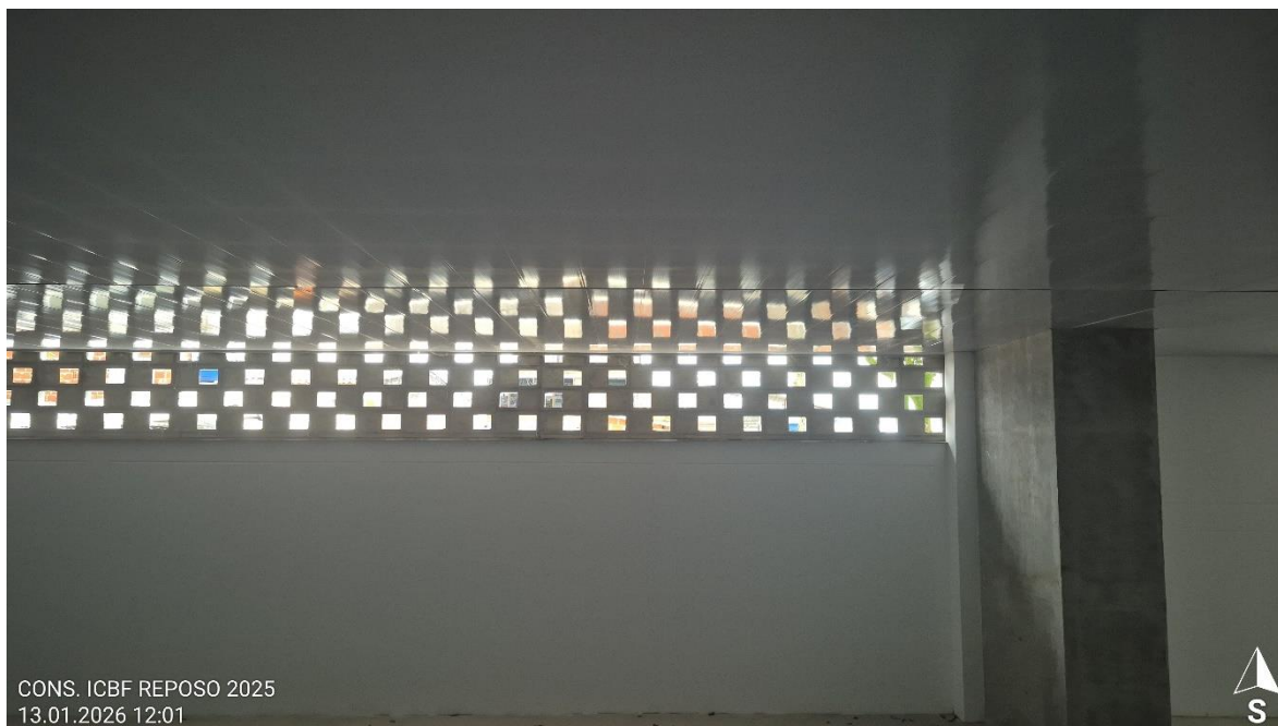
Imagen 5. Punto de filtración, gotera, Parqueadero 11 en placa de techo en N0.00 – 7.00 m.
