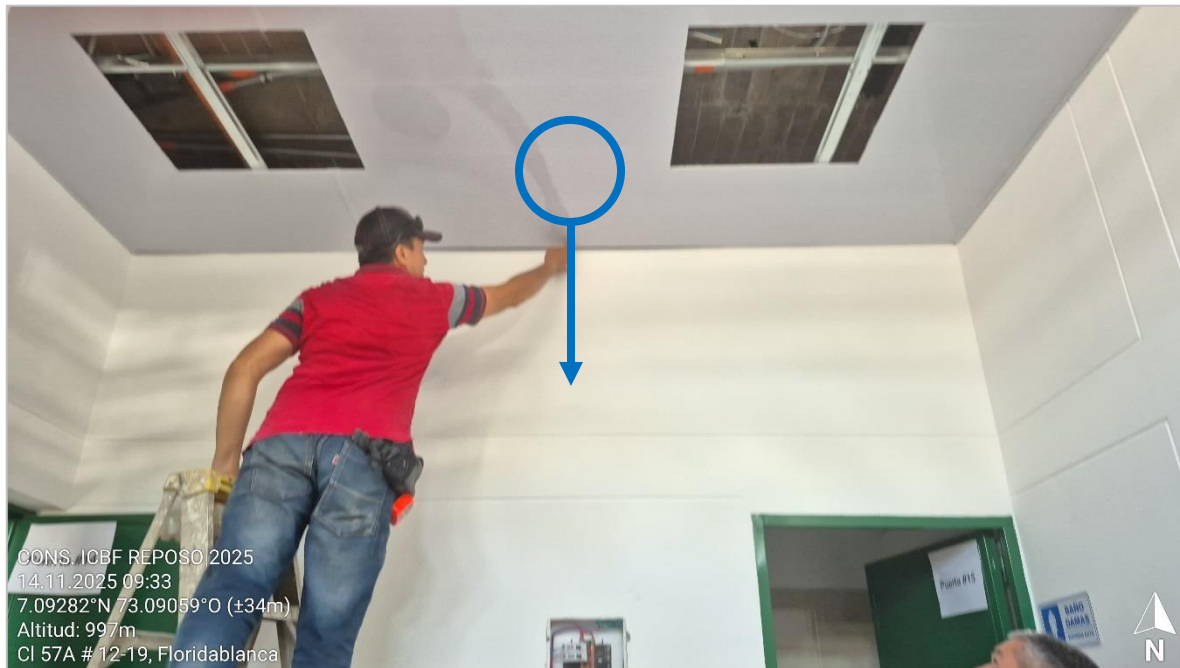
Imagen 1. Ubicación de caja de paso en cielo raso en oficina de auditorio con necesidad de ventana de inspección para derivación para empalmes o derivación de circuitos y futuros trabajos de mantenimientos o mejoras
