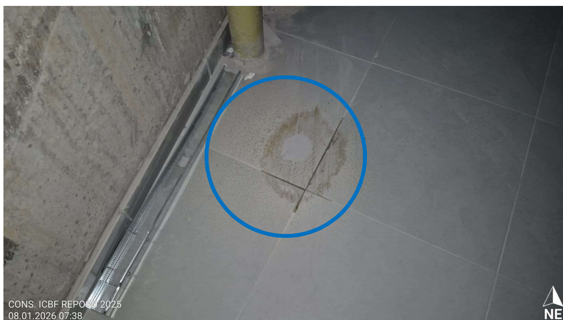
Imagen 2. Punto de filtración, gotera, en módulo de Nutricionista 02 en placa de piso en N0.00 – 4.00 m.
