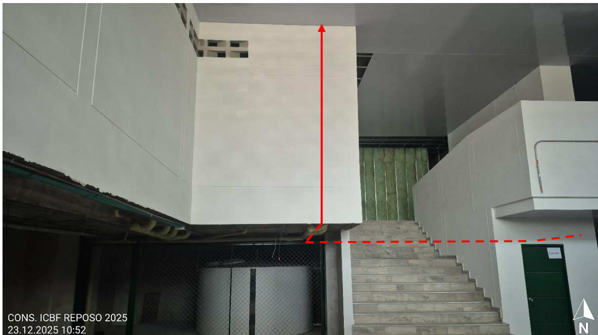
Imagen 1. Parqueadero N 0.00 – 7.00 m: Trayecto original para paso de bandeja portacables y redes eléctricas complementarias. El trayecto de ductos sería visible al acceder al parqueadero.
