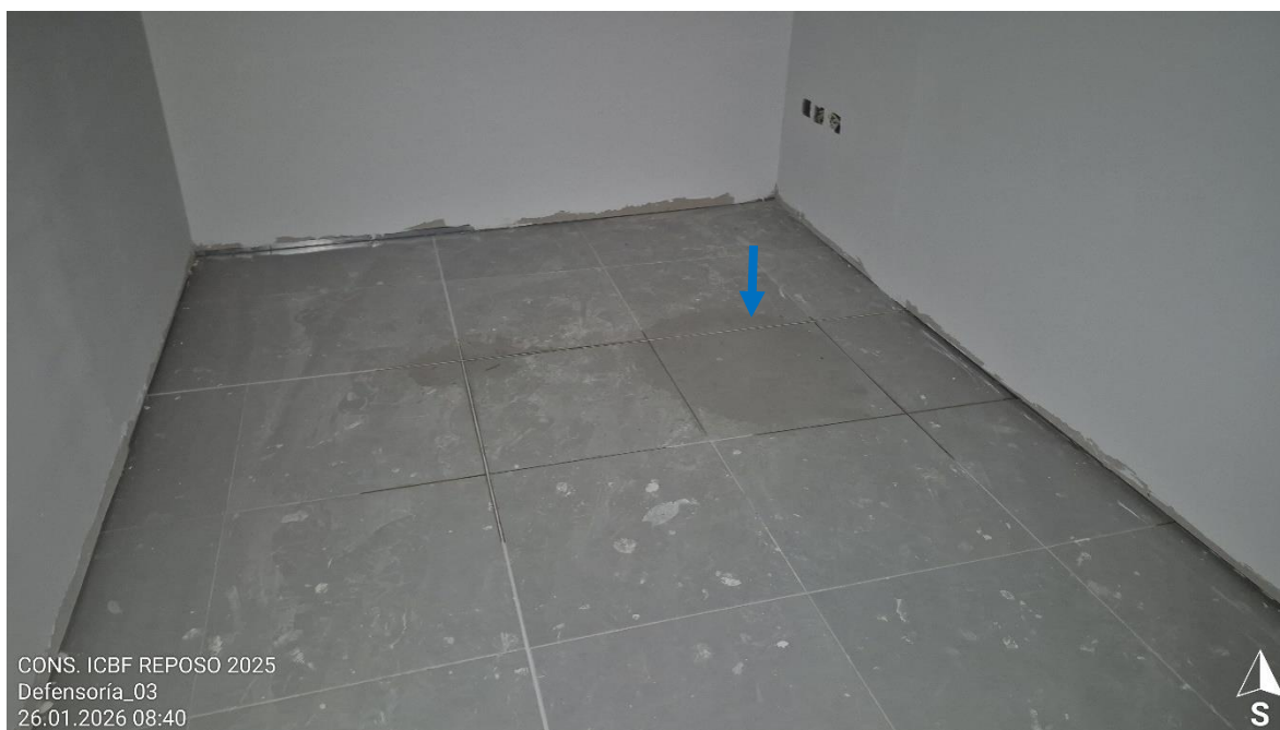
Imagen 2. Punto de filtración, gotera, en módulo de defensoría 02 en piso en N0.00 – 4.00 m.
