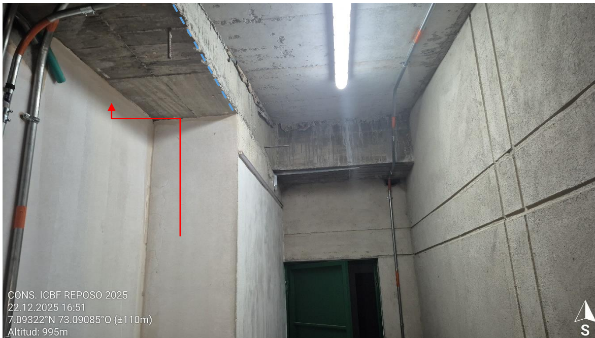
Imagen 6. Cuarto técnico N 0.00 – 7.00 m: Trayecto propuesto para paso de bandeja portacables y redes eléctricas complementarias. El trayecto llegaría de forma más directa al Nivel 0.00 - 4.00 m.
