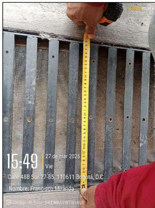
Ilustración 9. Protección de sumideros, Colegio Francisco Miranda Fuente: Autor.
