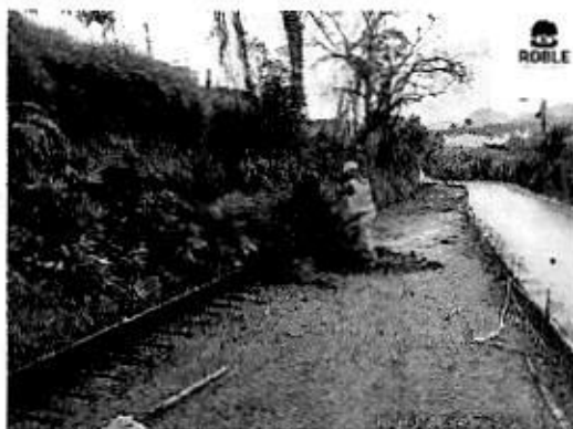
Ilustración 53 Afectación por precipitación
