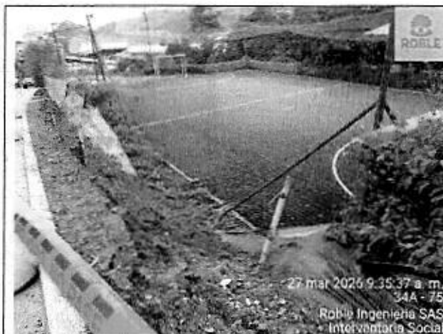
Ilustración 165 Desprendimiento de talud cancha hotel Valhala
