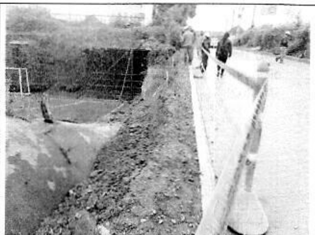
Ilustración 166 Visita técnica del desprendimiento de talud
