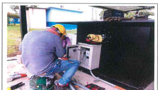
INSTALACIONES ELECTRICAS EN SOPLADORES PTAP GUACARI
