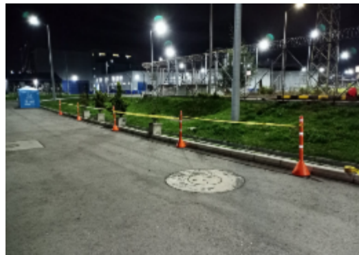
Delimitaron con cinta de peligro los conos utilizados para señalar zonas con exposición a riesgo eléctrico en el edificio de la CAR
