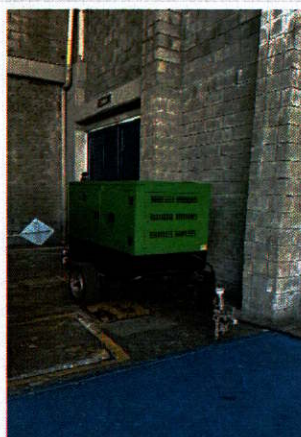
Fotografía N.º 1 — Ítem 21: PLANTA ELÉCTRICA
