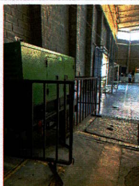
Fotografía N.º 3 — Ítem 21: PLANTA ELÉCTRICA
