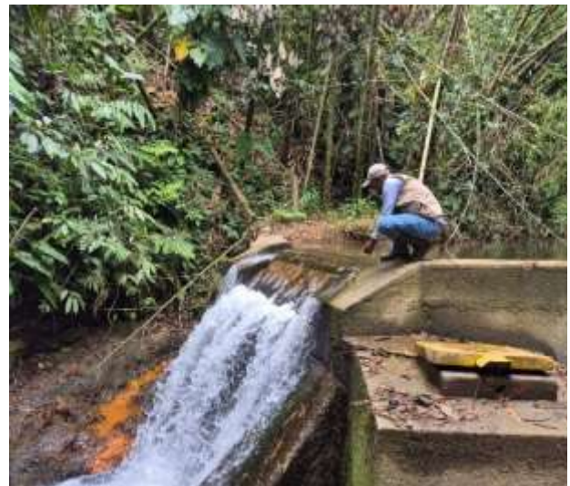
Bocatoma Sistema 1 Maravelez
