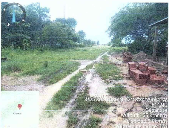
Foto 4. Vía de acceso al PAPS anegada e intransitable. Materiales de construcción (ladrillo) acopiados sin posibilidad de ingreso al frente. Coord: 4°26'30.82"N 72°18'34.29"W. Índice 141, Garibay, Casanare.
