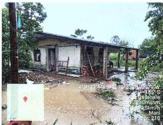
Foto 4. Vista frontal del PAPS con terreno completamente inundado. Se observan escombros de demolición rodeados de agua. Coord: 4°50'29.44"N 72°25'28.92"W. Índice 218, Maní, Casanare.
