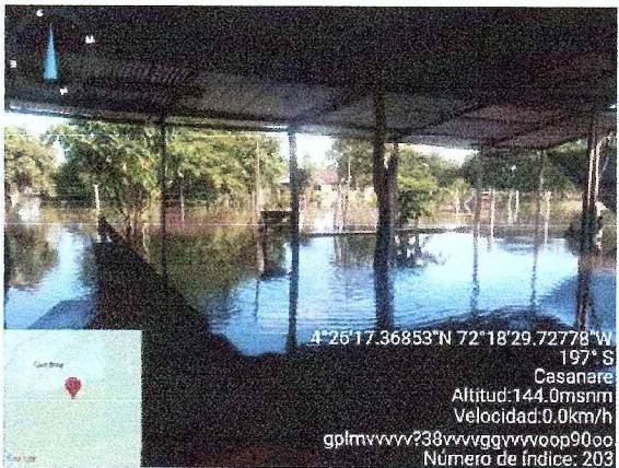
Foto 3. Segunda toma del interior inundado del PAPS. Nivel de agua sostenido que impide ejecución de actividades constructivas. Coord: 4°26'17.37"N 72°18'29.73"W. Índice 203, Garibay, Casanare.
