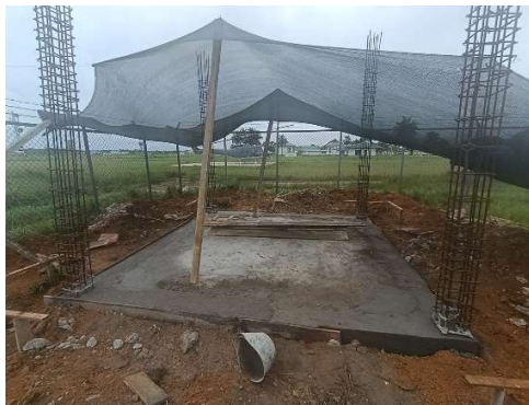
Placa de contrapiso
