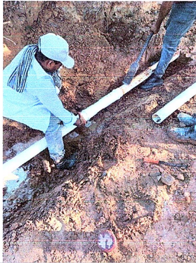
Fotografía 3. Reparaciones a daños en tubería.
