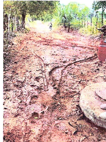
Fotografía 6. Terreno afectado por filtraciones de aguas negras.
