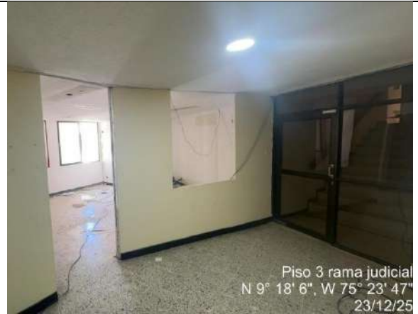
Foto inicial. oficina área sistemas 23-12-2025
