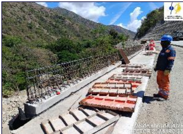
Fotografía 5-28 Muro 16 inactivo y no se pueden continuar las actividades hasta que se termine la estabilización del Calvario.
