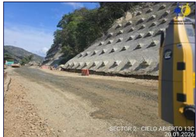
Fotografía 5-31 frente inactiva falta las barreras en concreto tipo new jersey.
