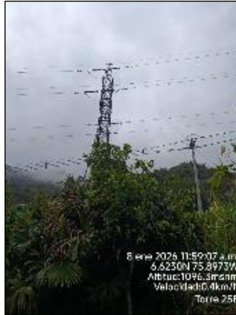
Fotografía 8-3 Ubicación Torre 25N con respecto a Línea 13.2 kV trifásica existente
