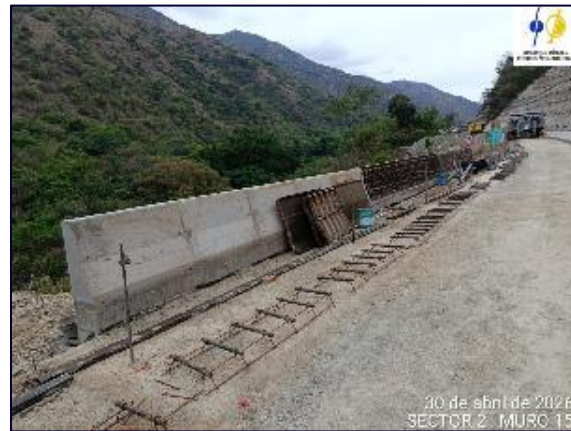
Fotografía 5-29 Muro 16 inactivo y no se pueden continuar las actividades hasta que se termine la estabilización del Calvario
