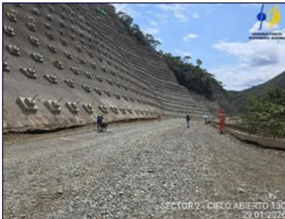
Fotografía 5-30 muro 16 frente inactiva falta las barreras en concreto tipo new jersey
