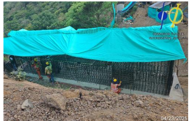
Fotografía 5-70 Puente 8, estribo 2, acero refuerzo.
