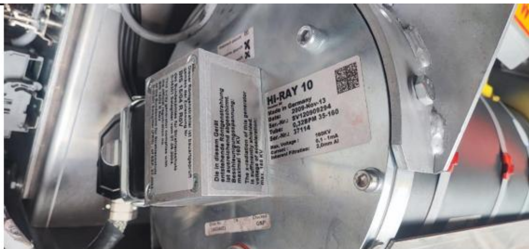
imagen 20. Generador recomendado a instalar para la maquina HI-RAY 10 identificado color gris corresponde a un generador de 160KVA, esto quiere decir que tiene mayor potencia, al realizar este cambio se requiere el cambio también de la fuente para un generador HI_RAY 10
