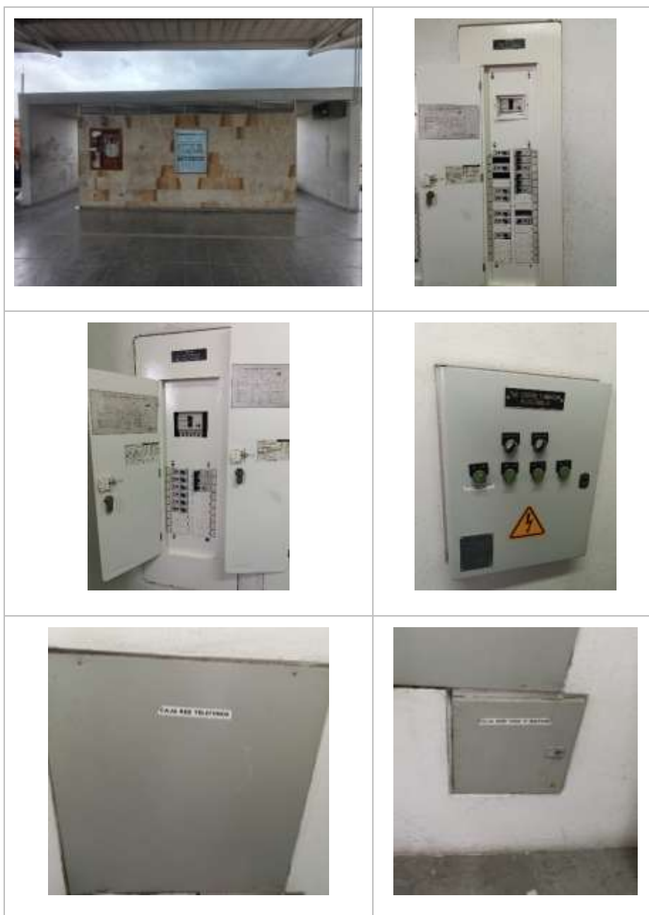
Fotografía 4 elementos en cuarto técnico plataforma de alimentación
