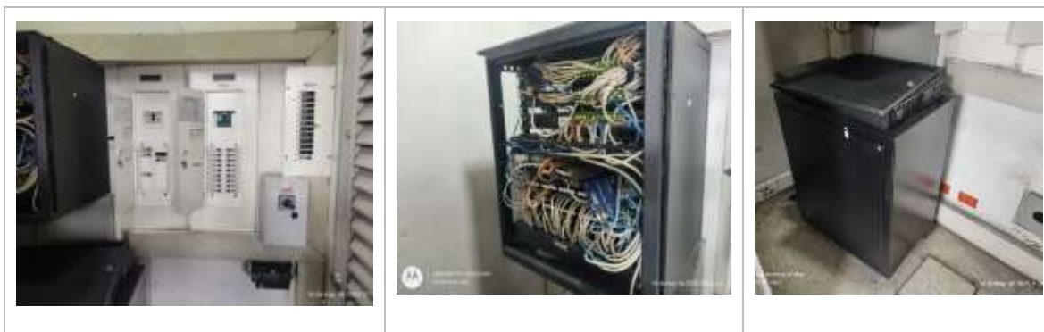
Fotografía 2 elementos en cuarto de control Recaudo
