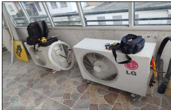
AIRES ACONDICIONADOS TRASLADADOS INTERNOS
