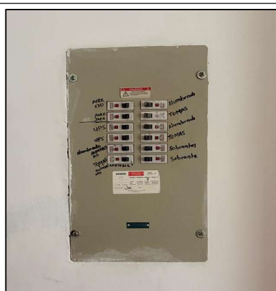
CONEXIÓN A TABLERO GENERAL
