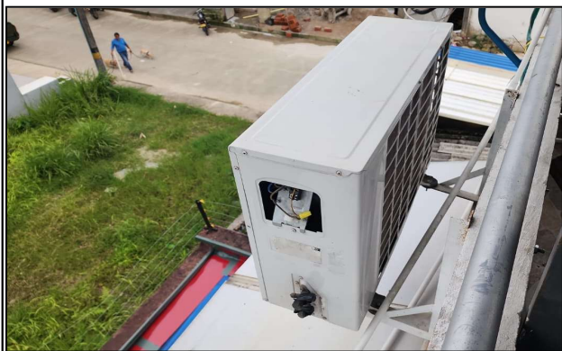
AIRE ACONDICIONADO TRASLADADO EXTERNO
