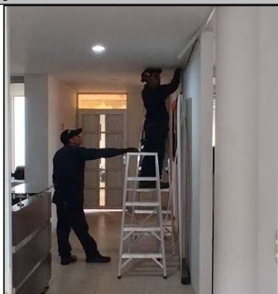
INSTALACIÓN ELECTRICA A 220V EN CANALETA METALICA
