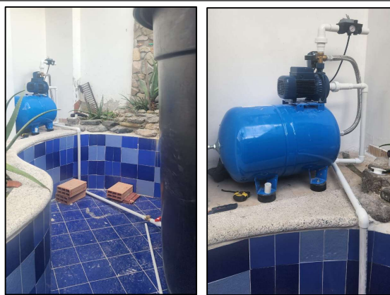
VISTA GENERAL INSTALACIÓN BOMBA A TANQUE
