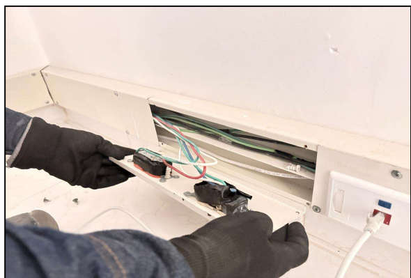
REVISIÓN CONEXIONES ELECTRICAS - TOMACORRIENTES
