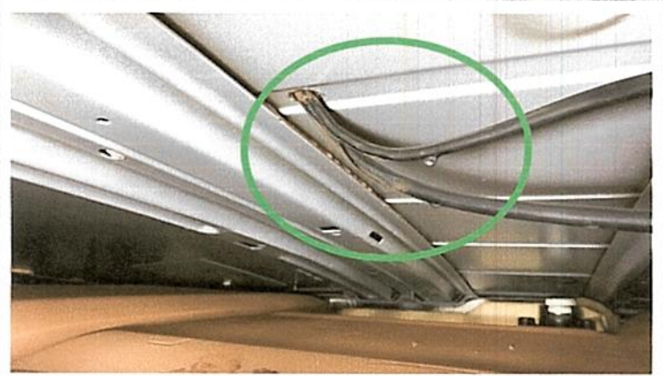
Filtración de agua por apertura en el techo
