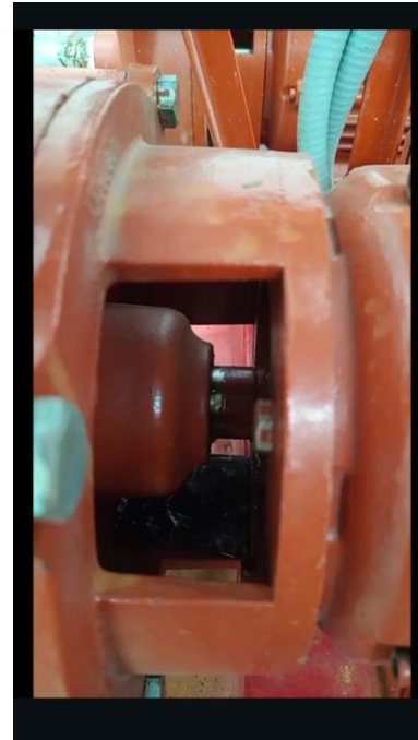
MOTOBOMBA PARA REVISION Y MANTENIMIENTO
