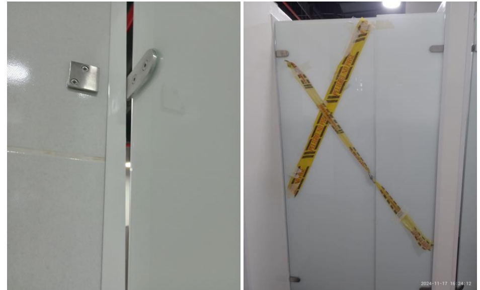
PUERTAS DE VIDRIO DESAJUSTADAS
