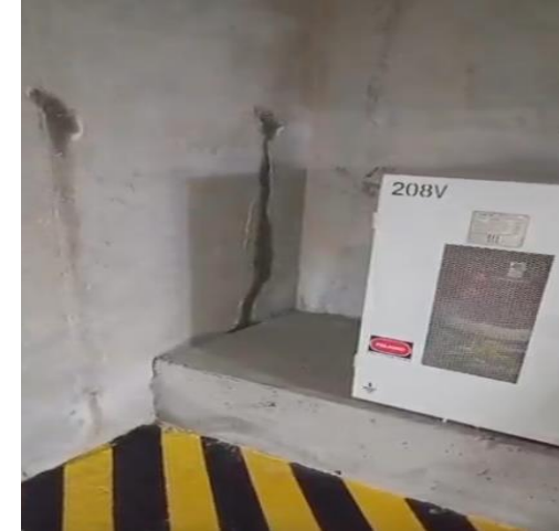
FILTRACIONES PISCINA RECREATIVA EN ZONA SUBTERRANEA
