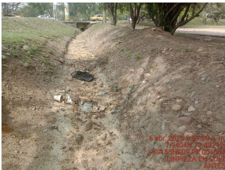
LIMPIEZA DE ENCOLE Y DESCOLE (ANTES)
