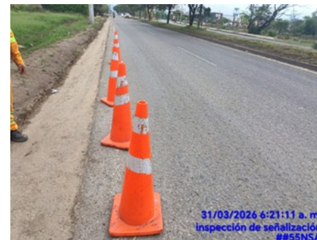
SEGUIMIENTO INSPECCION CONOS DE SEGURIDAD
