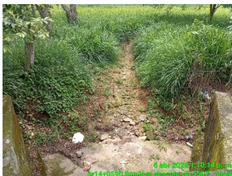
LIMPIEZA DE ENCOLE Y DESCOLE (ANTES)
