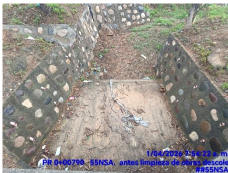
LIMPIEZA DE ENCOLE Y DESCOLE (ANTES)
