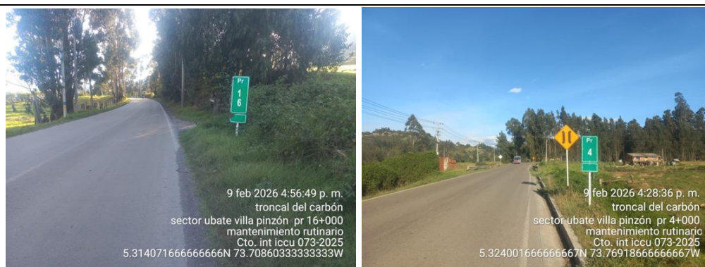
Ilustración 6. Estado inicial troncal Ubate. Fuente Propia Interventoría
