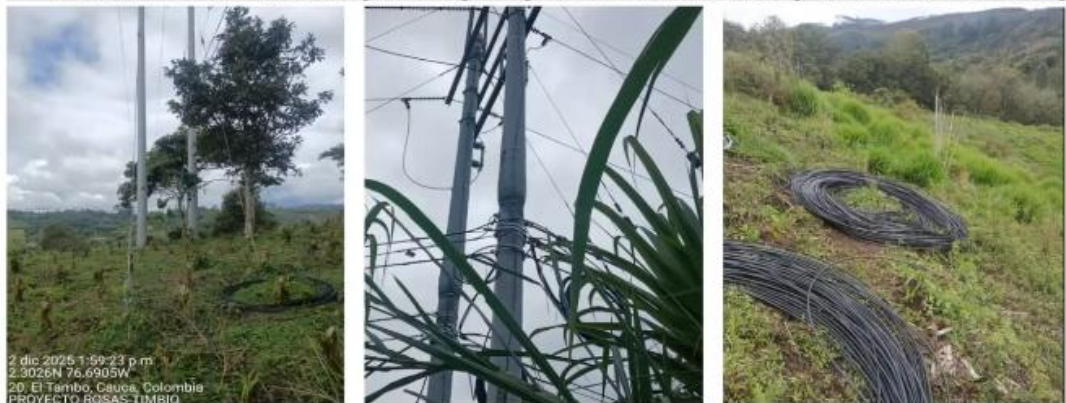
Imagen 3. Tendidos de fibra óptica. Fuente: presentación gobernación de Cauca.
