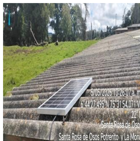
Fotografía 16 Panel solar del impulsor funcional. Predio Potrerito y La Mona
