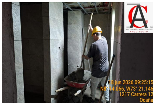
Fotografía No. 10. Granito fundido en tercer piso zona de baños.
