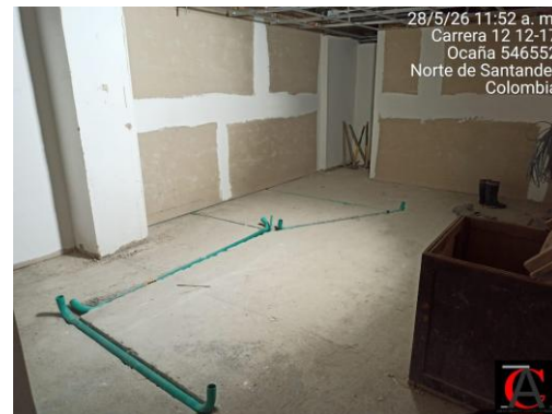
Fotografía No. 16. Instalaciones eléctricas, piso 1.
