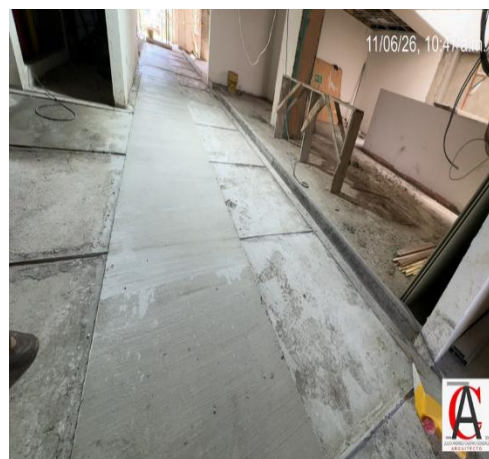
Fotografía No. 4. granito fundido en tercer piso
