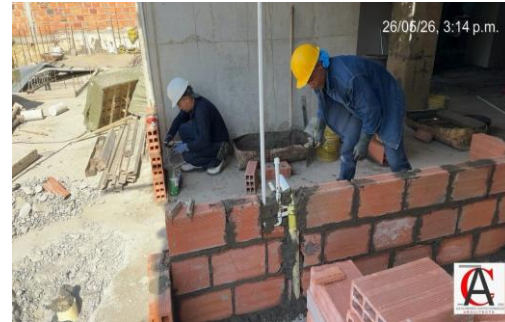
Fotografía No. 14. Muro en mampostería e instalaciones hidrosanitarias, piso 1.
