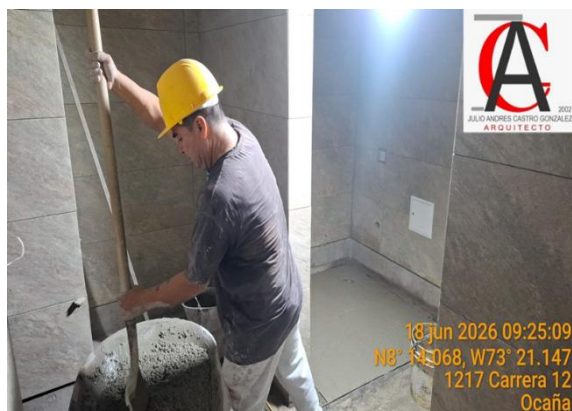
Fotografía No. 9. Granito fundido en tercer piso zona de baños.
