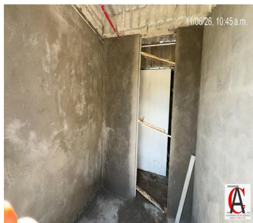
Fotografía No. 3. pañete zona archivo primer piso
