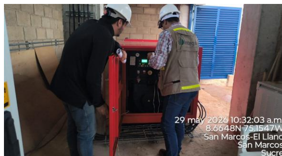
Visita técnica - Red eléctrica interna estación de bombeo Pondaje 4
