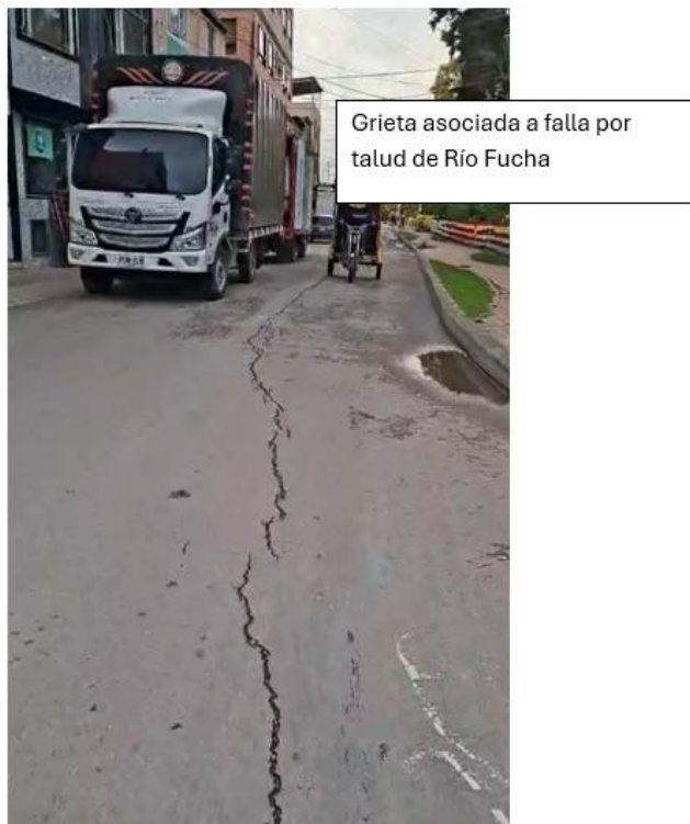
Imagen 2 Grieta asociada a falla por talud de Río Fucha
