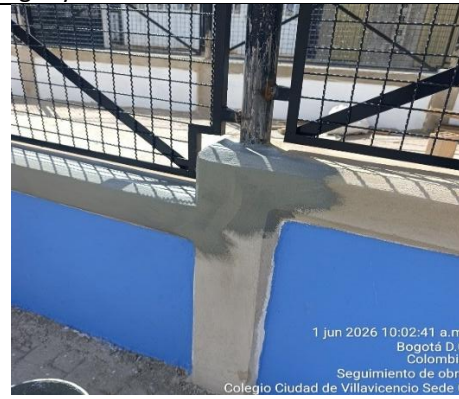
Ilustración No.34: Aplicación de pintura azul pacifico para acabado final de muros y gris basalto en vigas y columnas
