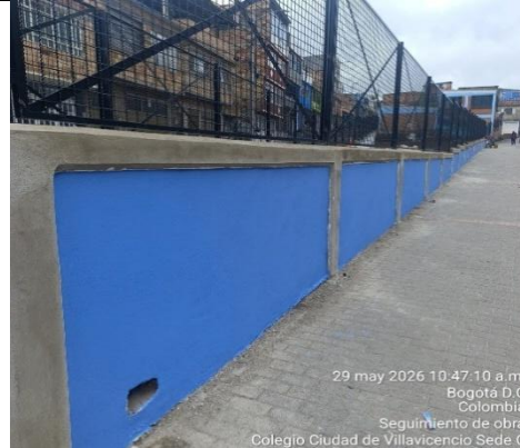
Ilustración No.32: Aplicación de pintura azul pacifico para acabado final de muros y gris basalto en vigas y columnas
