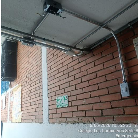
Ilustración No.13: Interruptores de pasillos
