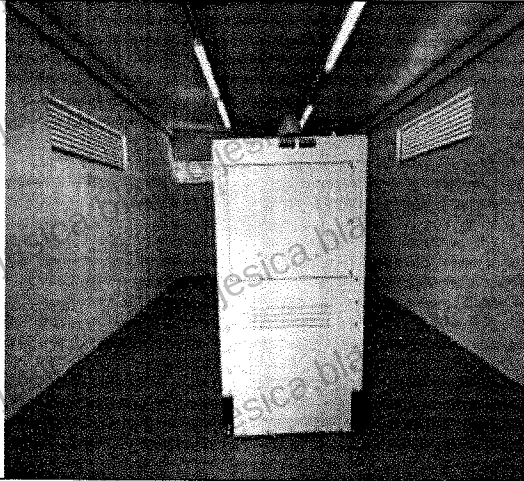
PANORAMICAS CUARTO ELECTRICO
