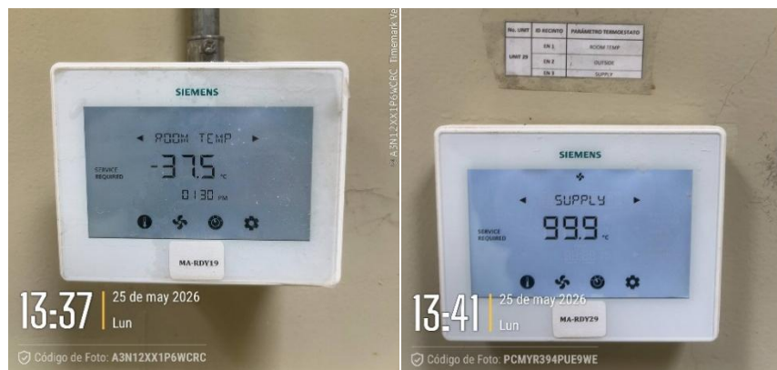
Foto 46-47. Fallas en pantallas de registro de temperatura
