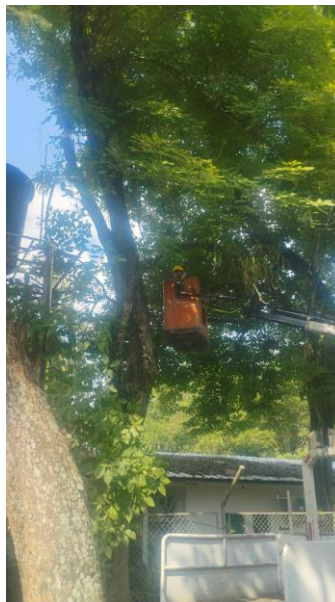
Imagen 3. Soporta la poda de las ramas de matarratón los cuales tienen riesgo de caída sobre los techos de la bodega de insumos de aseo.
