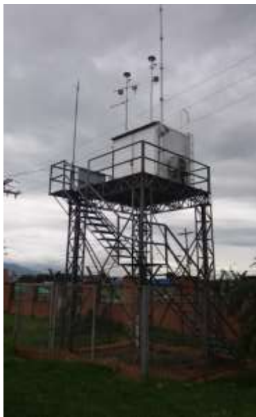
Estación Automática de monitoreo de calidad del aire de la CAR. Zipaquirá EFZ.
