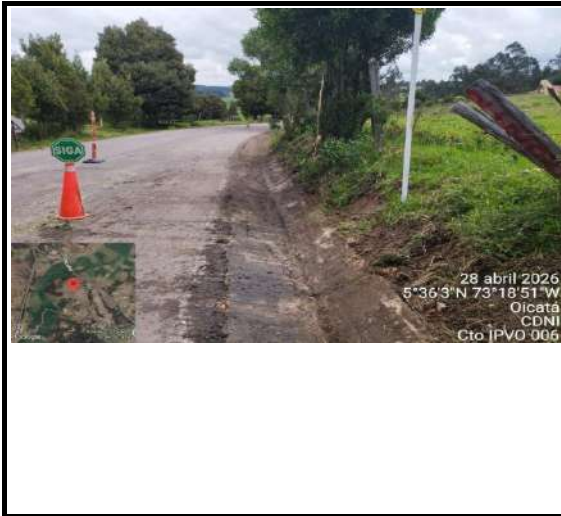
Descripción de la fotografía Estado inicial de la cuneta
