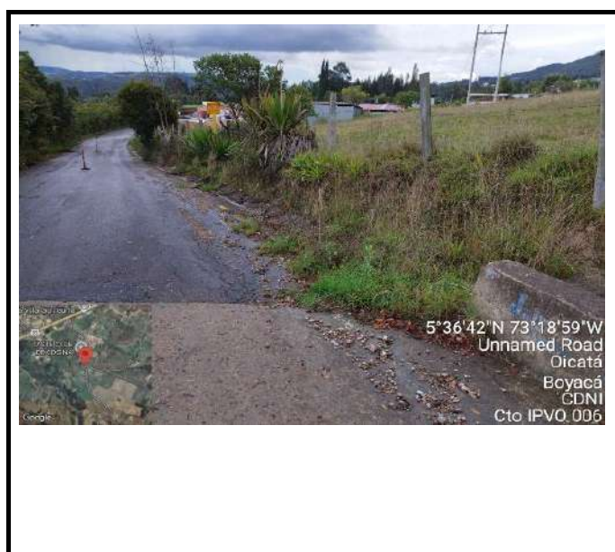
Descripción de la fotografía Estado inicial del descole de la cuneta
