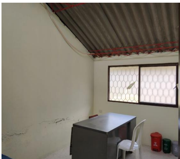
Ilustración 4 – Cubierta a cambiar y muros con humedad Centro de Salud - sede Guapuscal Bajo
