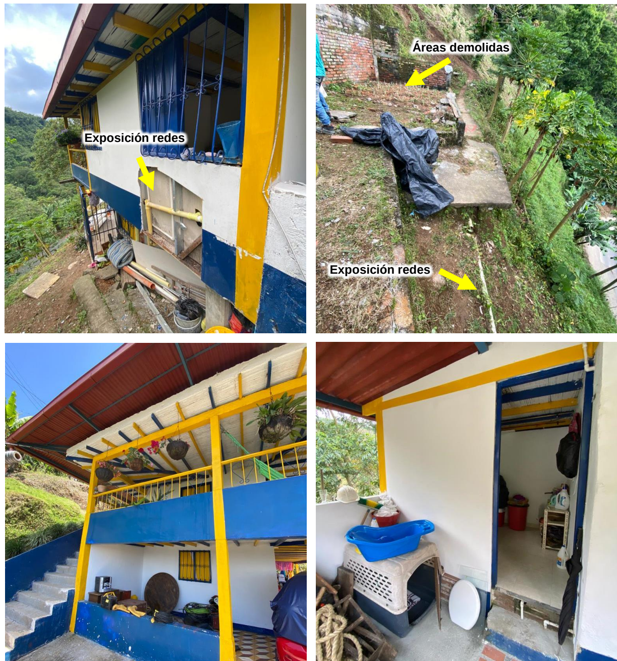
Figura 10. Estado actual de la vivienda en la Finca Rey Sol.
