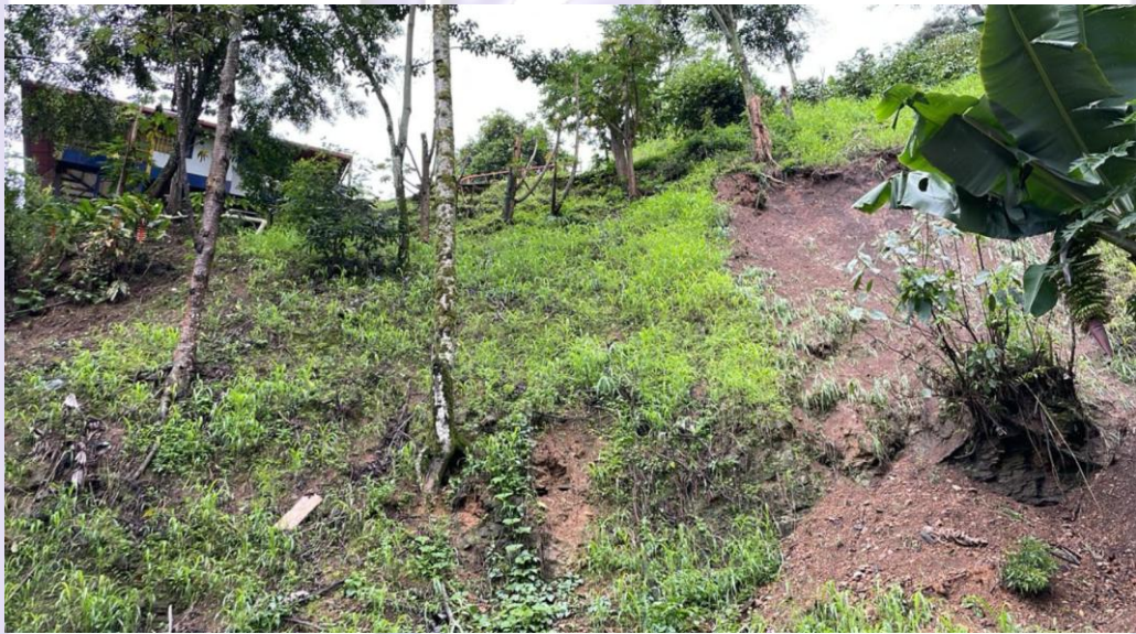
DESPRENDIMIENTO DE CAPA VEGETAL Y TIERRA DEL TALUD DE LA FINCA REY SOY
