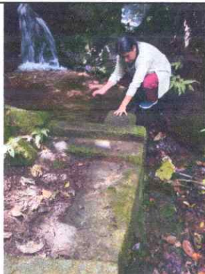
TAPAS DEL TANQUE LA FLORESTA QUE ESTAN DAÑADAS
