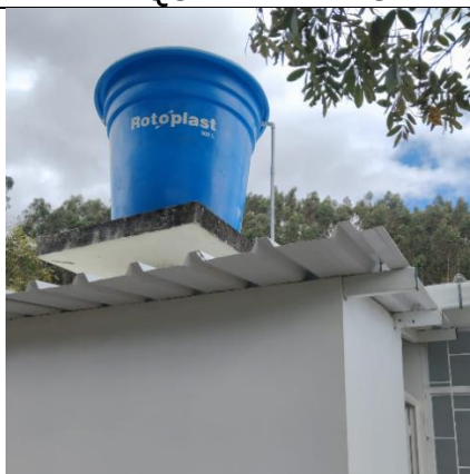
Ilustración 2 – VISTA TANQUE DE ALMACENAMIENTO
