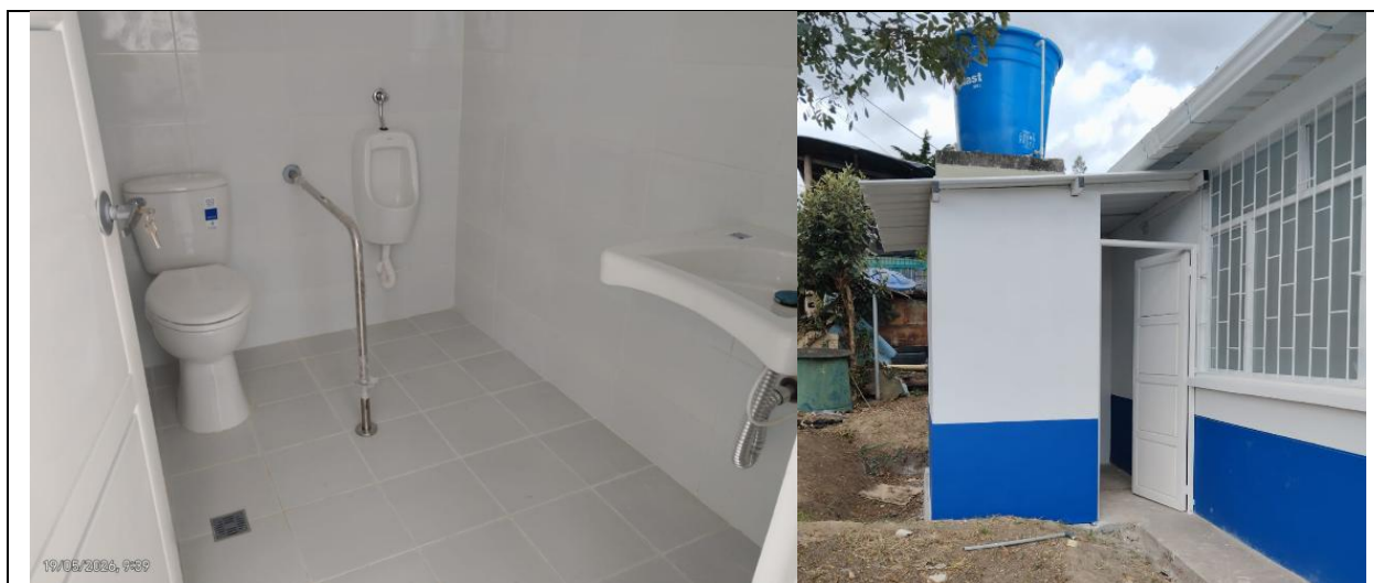
Ilustración 6 – SANITARIO, ORINAL, LAVAMANOS, BARRAS PMR ZONA SHUT DE BASURAS
