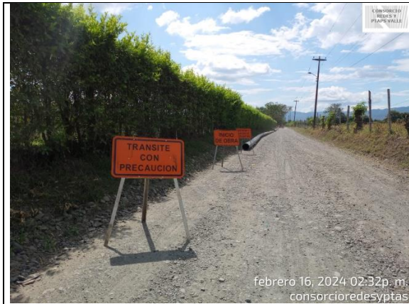
Fotografía 41. Señalización en sitio de pega de tubería
