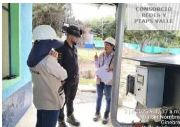
Fotografía 64. Se evalúa la puesta en operación de los dos Sopladores y las recomendaciones del proveedor.
