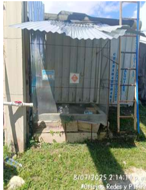
Foto 12. Almacenamiento de combustible- PTAP Ginebra
