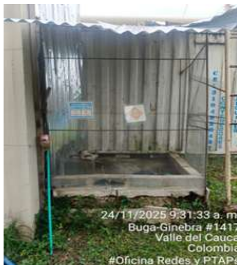
Foto 12. Almacenamiento de combustible- PTAP Ginebra
