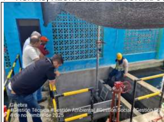
Fotografía 85. Prueba de falsos fondos con aire para evaluar su operación.
