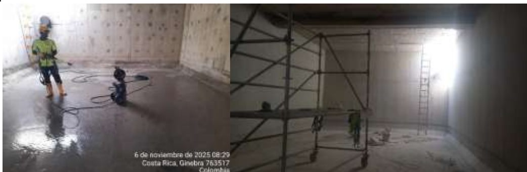
Ilustración 24. Orden y aseo de los compartimientos del tanque para inicio de la preparación de superficies.
