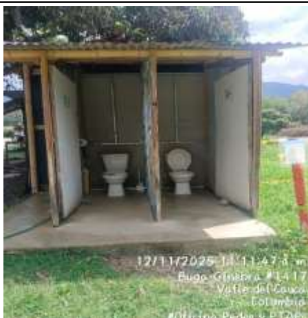
Foto 15. Lavado de baños – PTAP Ginebra
