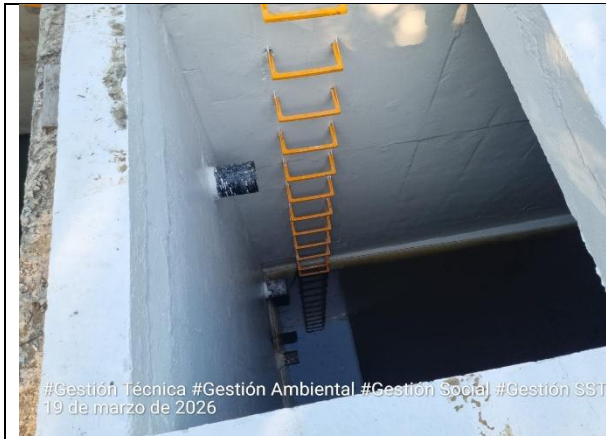
Fotografía 7. Durante la oleada invernal se presentó un imprevisto de inundación del tanque de la Albania por desborde de acequia colindante al predio.
