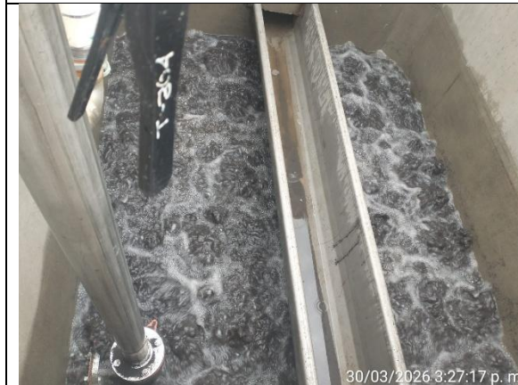
Fotografía 33. Lavado de Gravas de soporte de material Filtrante.
