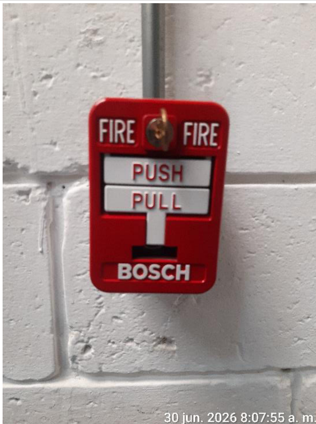
Foto 22. Verificación de los sistemas de seguridad (alarma contra incendio), en cumplimiento de la obligación 15 del contrato.
