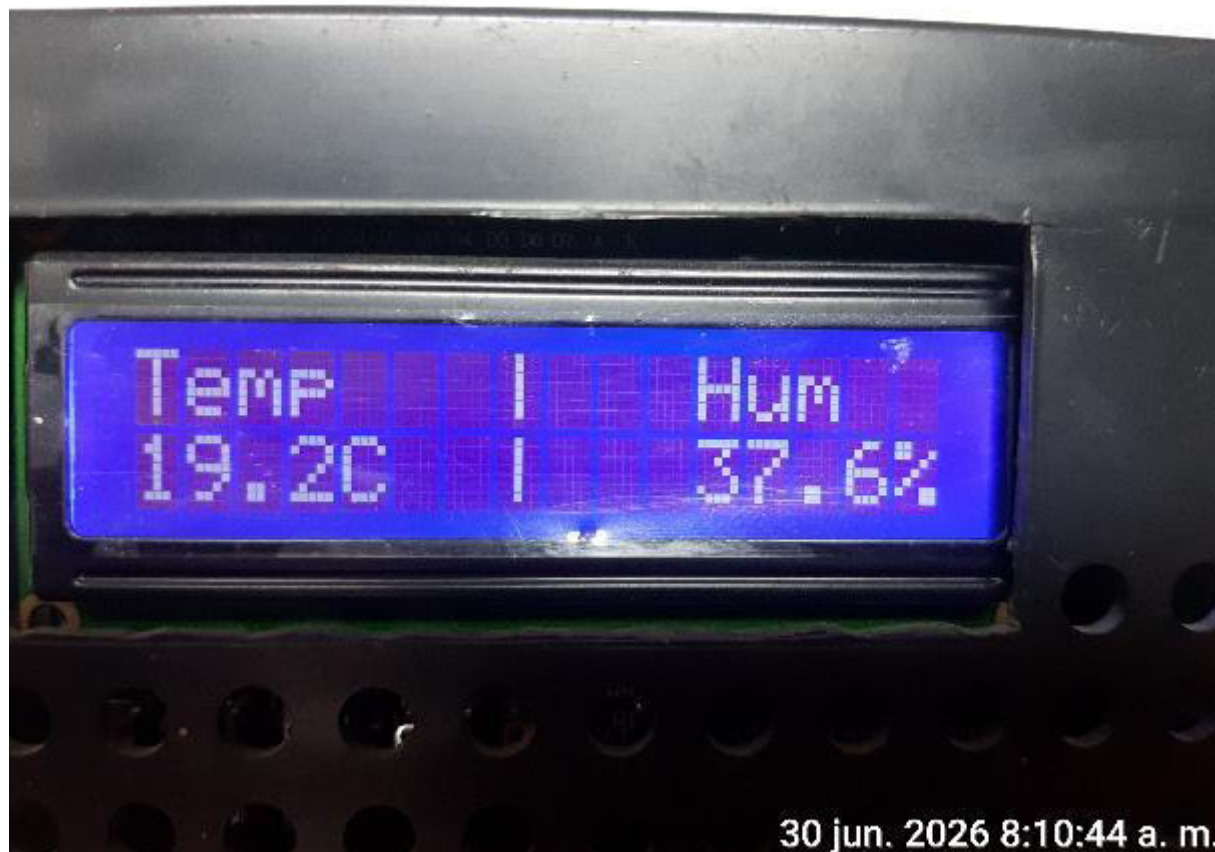
Foto 12. Detalle de lectura de humedad relativa de 37.6% y temperatura de 19.2°C para soporte medio óptico durante la visita del 30 de junio de 2026, la cual está de conformidad con lo estipulado en el numeral 4.2. del Anexo del contrato.
