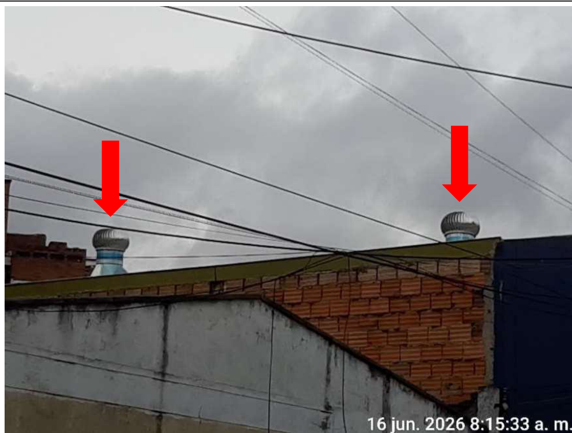
Foto 12. Vista externa de los extractores eólicos.
