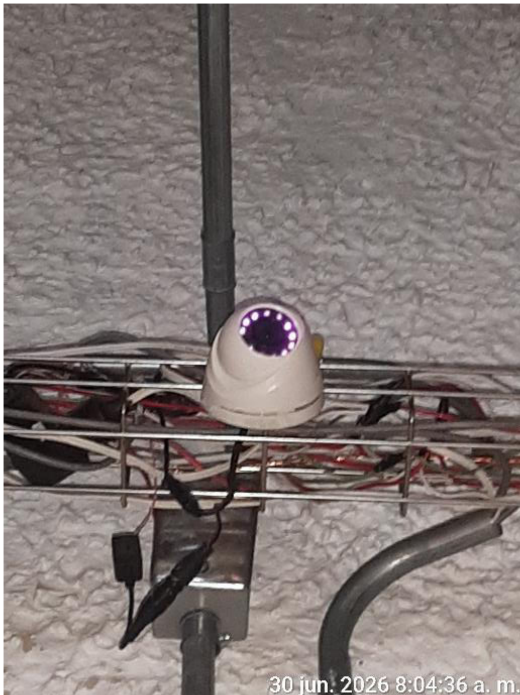
Foto 16. Verificación de los sistemas de seguridad (cámara de seguridad), en cumplimiento de la obligación 15 del contrato.
