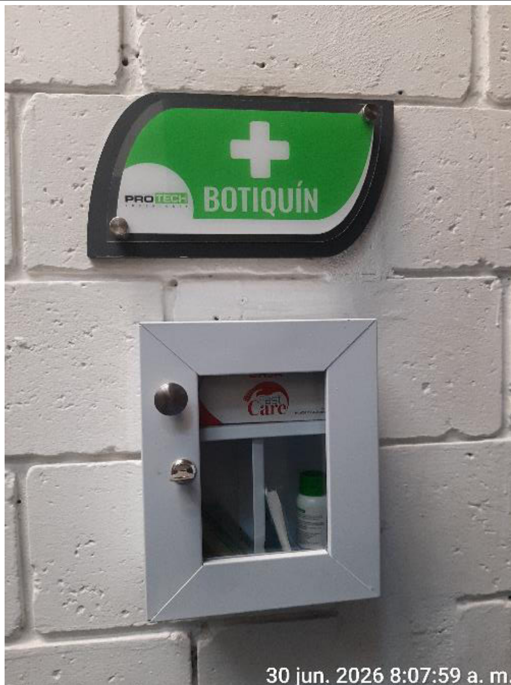
Foto 21. Verificación de los sistemas de seguridad (botiquín), en cumplimiento de la obligación 15 del contrato.
