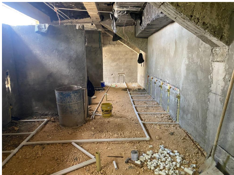
Ilustración 19. Instalaciones hidrosanitarias baños graderías de futbol
