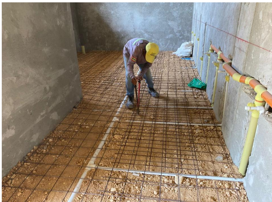
Ilustración 20. Instalaciones hidráulicas baños graderías de futbol
