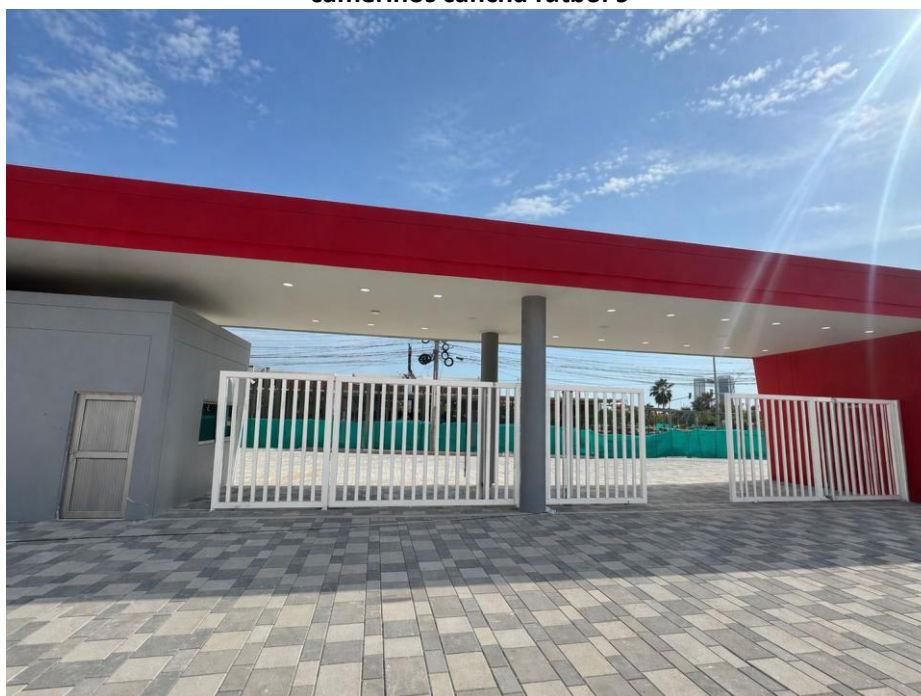
Ilustración 29. Pintura, cielo raso acceso principal
