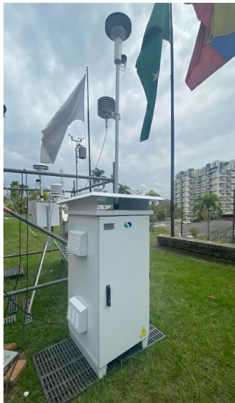
Fotografía: Un (1) equipo automático de medición de partículas menores de 10 micras pm-10 con sistema controlador de flujo volumétrico de atenuación beta E-BAM Plus
