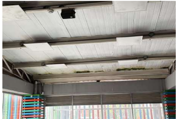
AFECTACIONES DE CUBIERTA Y CANAL
