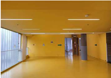
ALA AMARILLA CON AFECTACIONES EN LUMINARIAS Y HUMEDAD
