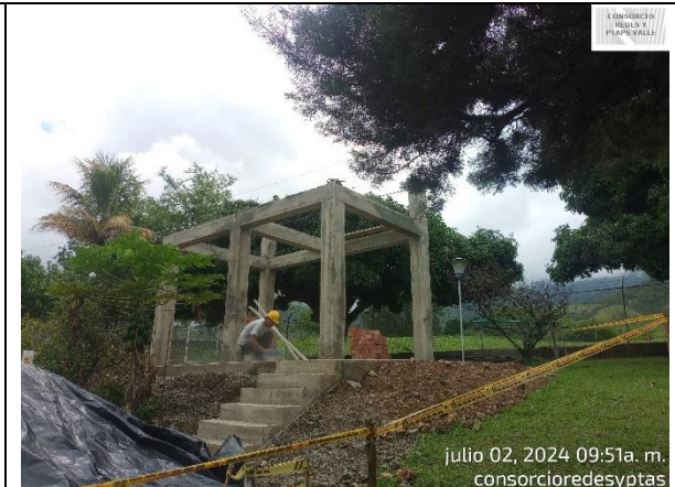
Fotografía 2. Caseta eléctrica de la PTAP Ginebra.
