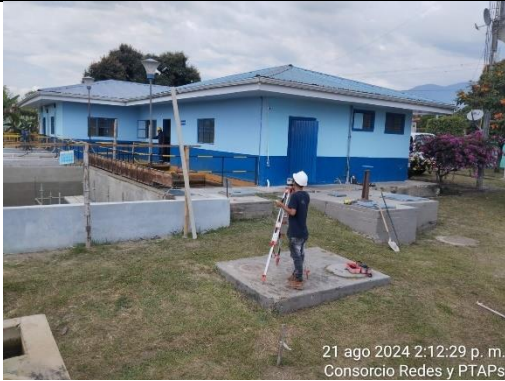
Fotografía 67. Levantamiento niveles sedimentadores y Filtros
