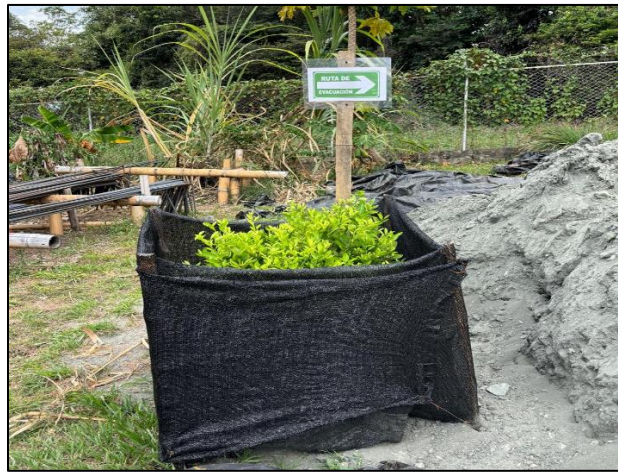
Foto 3. Cercos de Protección – PTAP Ginebra
