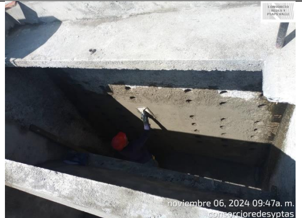
Fotografía 6. Repello de la pantalla perforada del sedimentador No. 2 en la PTAP Ginebra.
