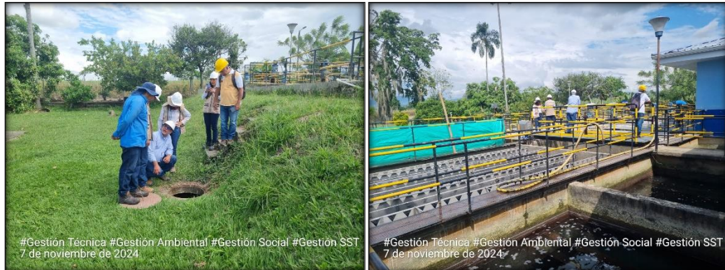
Ilustración 12. Puesta en operación del Barrelos del Sedimentador No.1 de la PTAP Guacarí.
