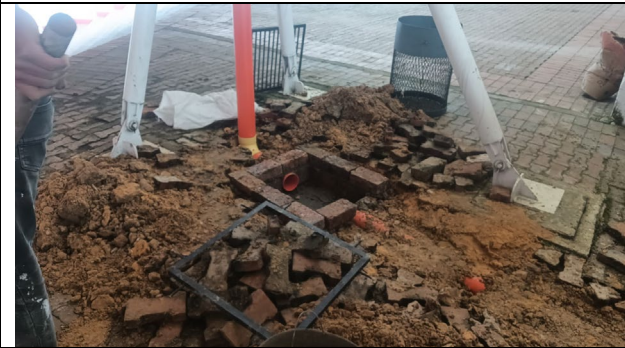
CAJA DE INSPECCION AGUAS LLUVIAS
