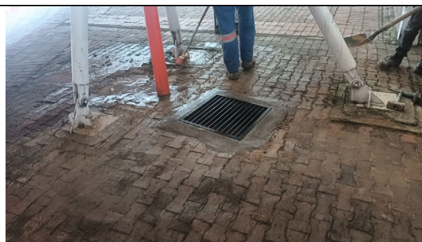
CAJA INSPECCION GUAS LLUVIAS
