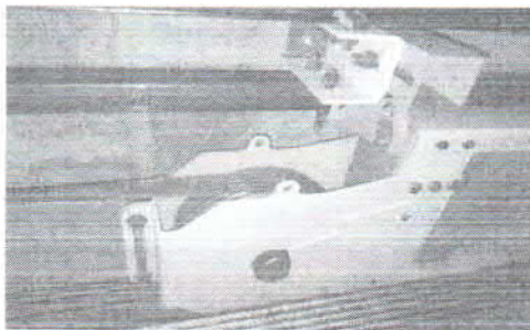
Foto 1. Ausencia de guardacables en polea de contrapeso.
