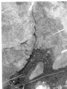
Fotografía 22. Fisuración cara exterior del dique Fuente: Registro SEDAMA
