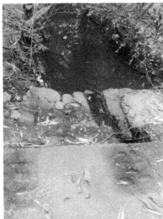
Fotografía 37. Ocupación de cauce Fuente: Registro SEDAMA
