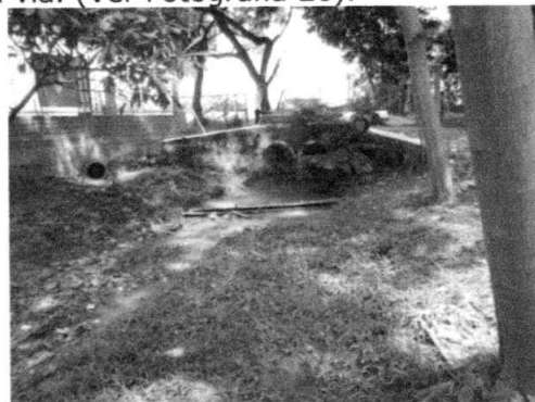
Fotografía 27. Obra de drenaje en la vía de acceso – cabezal de salida. Fuente: Registro SEDAMA
